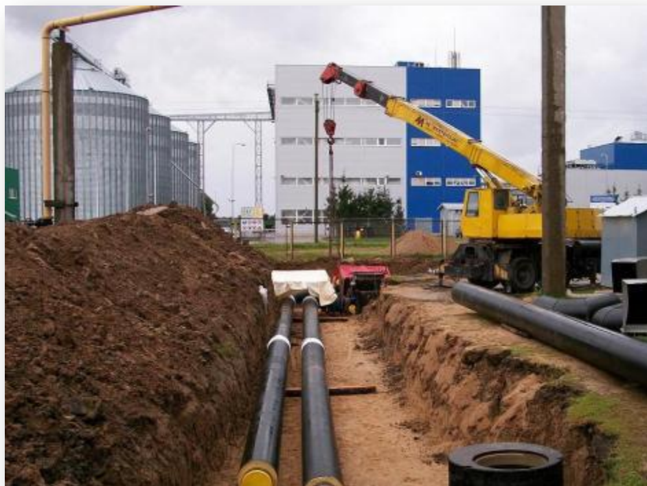
Zarasų RK modernizavimas (pastatytas naujas 4,0 MW galios biokuro vandens šildymo katilą, projekto vertė 5,7 mln. Lt )
